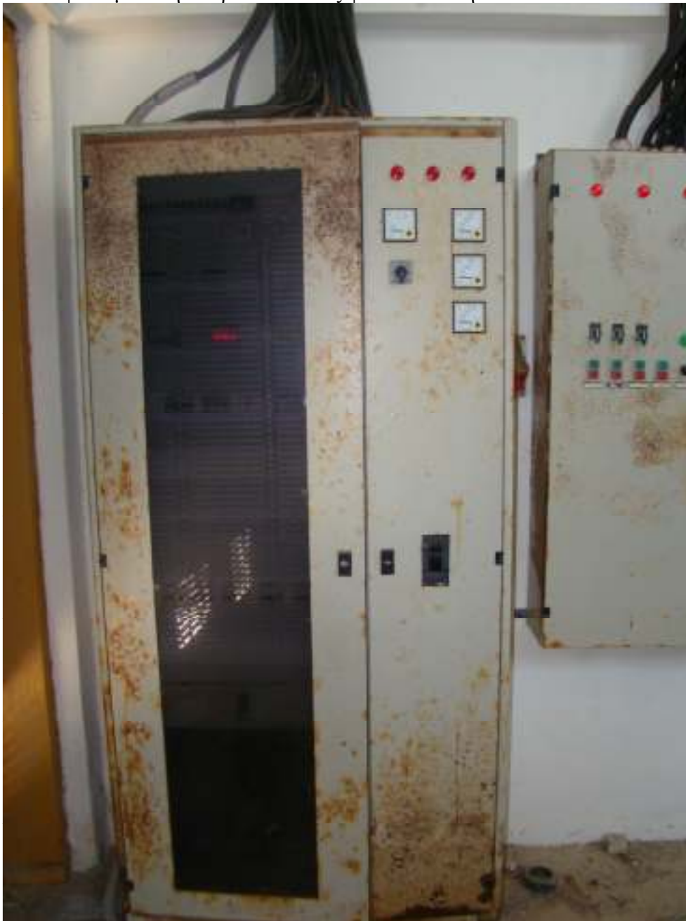
Εικόνα 11: Κεντρικός ηλεκτρικός πίνακας
