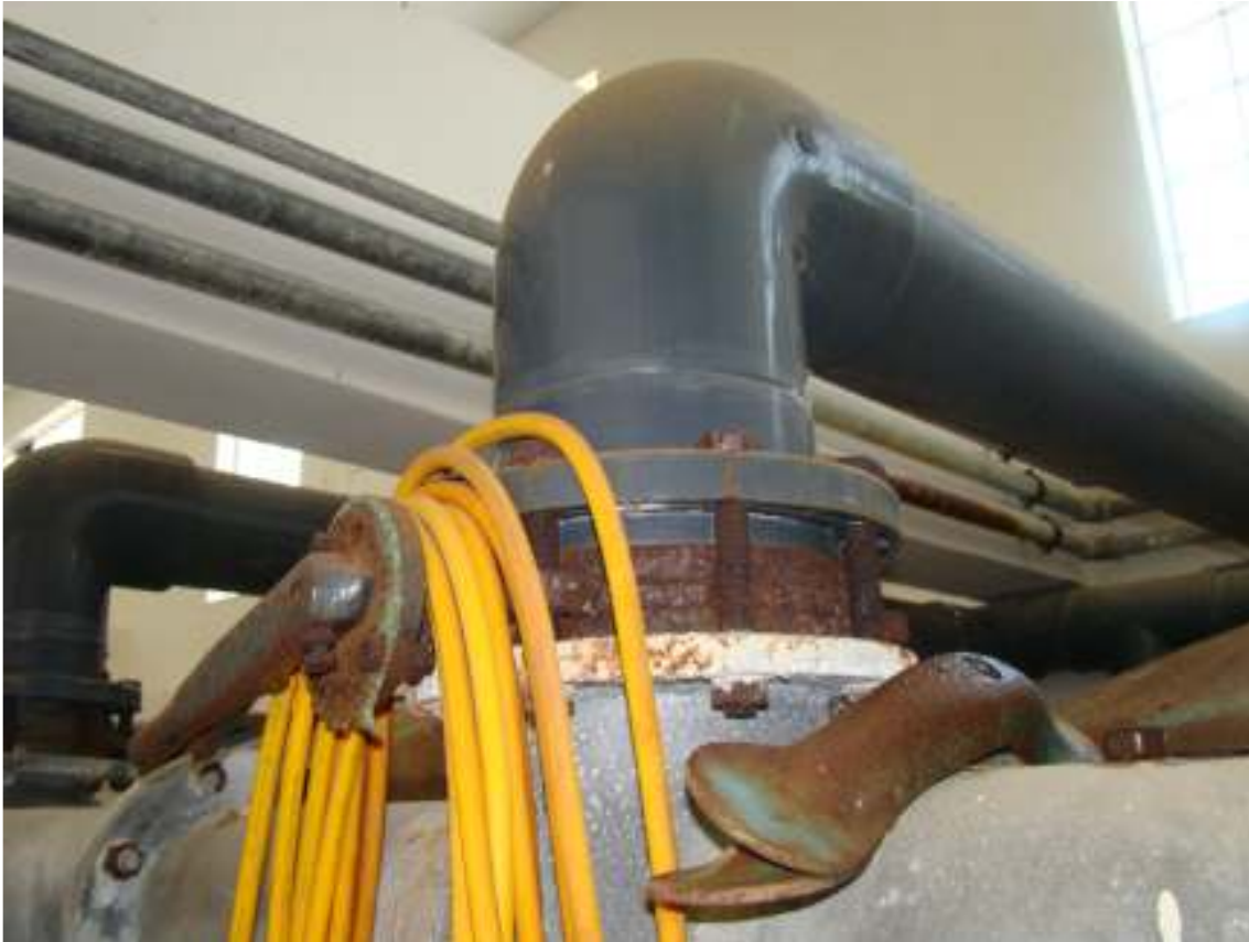
Εικόνα 17: Βάνες πεταλούδα προς αντικατάσταση
