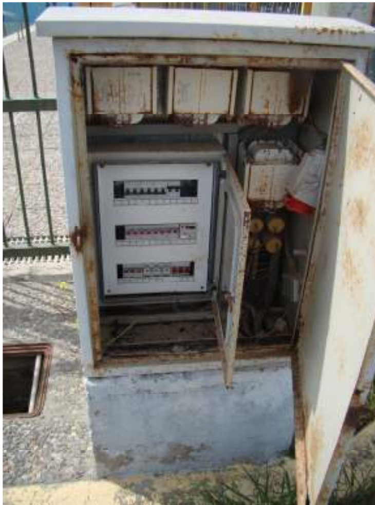
Εικόνα 18: Πίλαρ εξωτερικού φωτισμού
