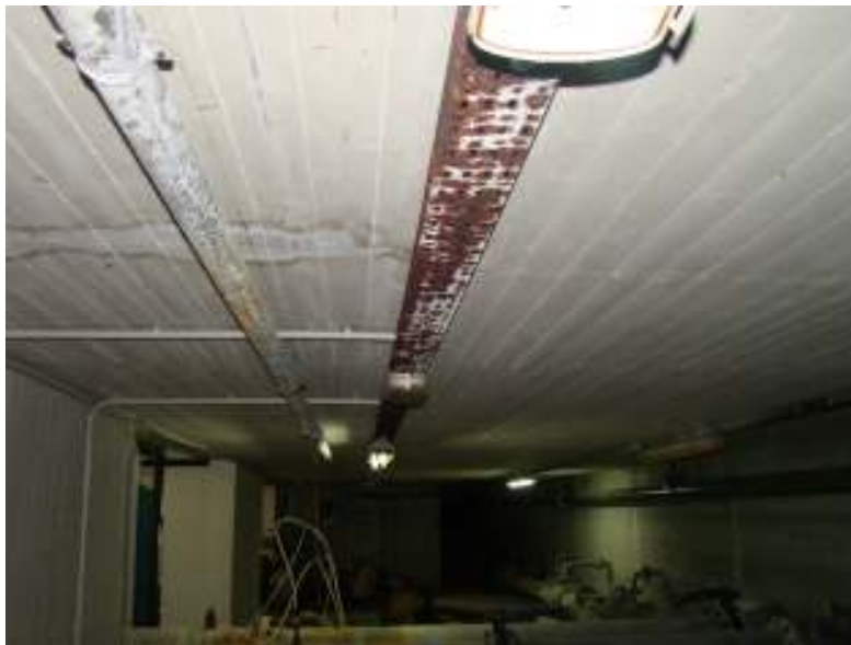
Εικόνα 14: Σχάρες καλωδίων προς αντικατάσταση
