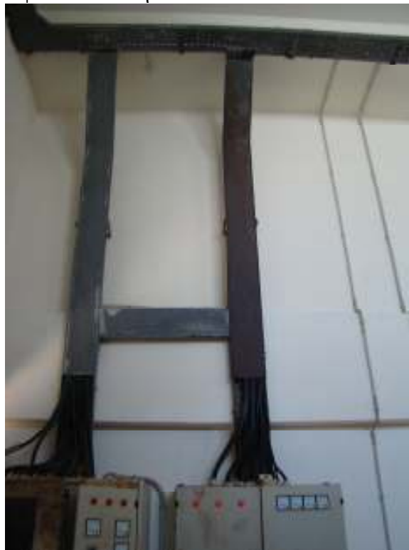
Εικόνα 13: Σχάρες καλωδίων προς αντικατάσταση
