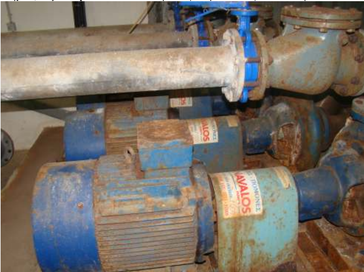
Εικόνα 19: Υφιστάμενες αντλίες ανακυκλοφορίας.
